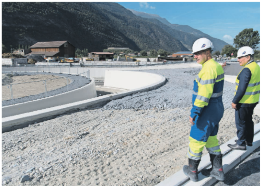
Augenschein. Staatsrat Melly und Martin Hutter inspizieren die Kunstbauten beim Vollan schluss Visp West.
